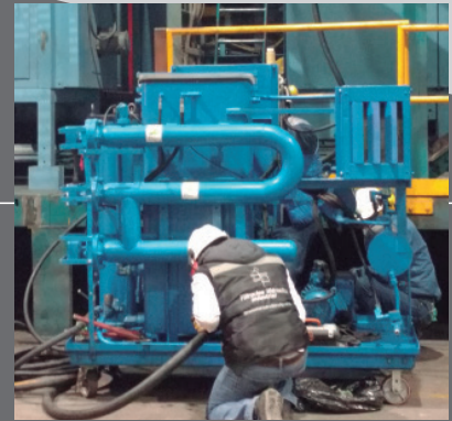
Filtrado y Deshidratación de Aceite
